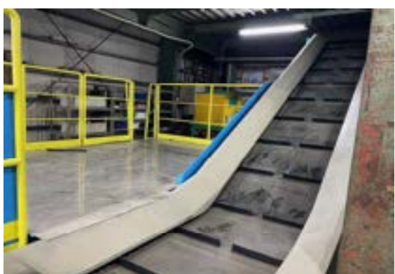
【搬送用コンベア】
